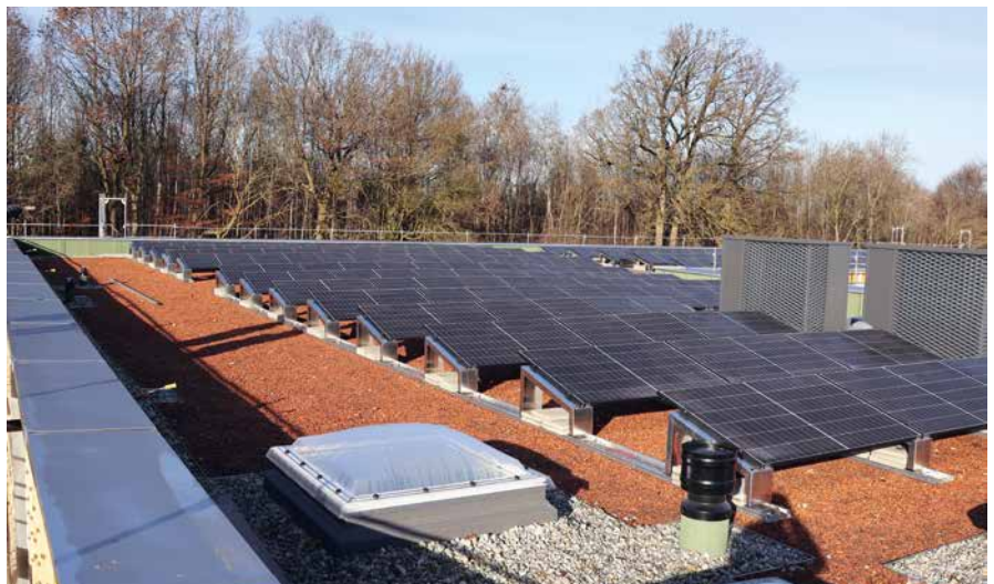
▶ Gründach mit PV-Anlage und Wärmepumpen
