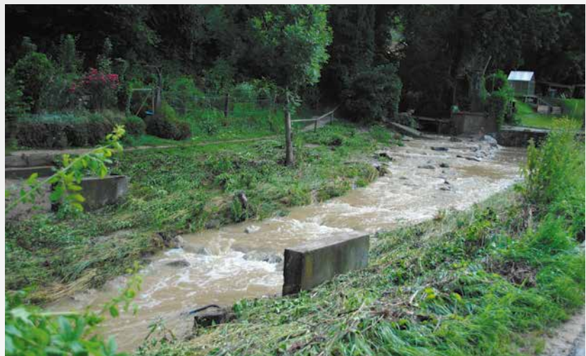
► Brücke über den Roßbach wurde durch die Wassermassen weggespült
